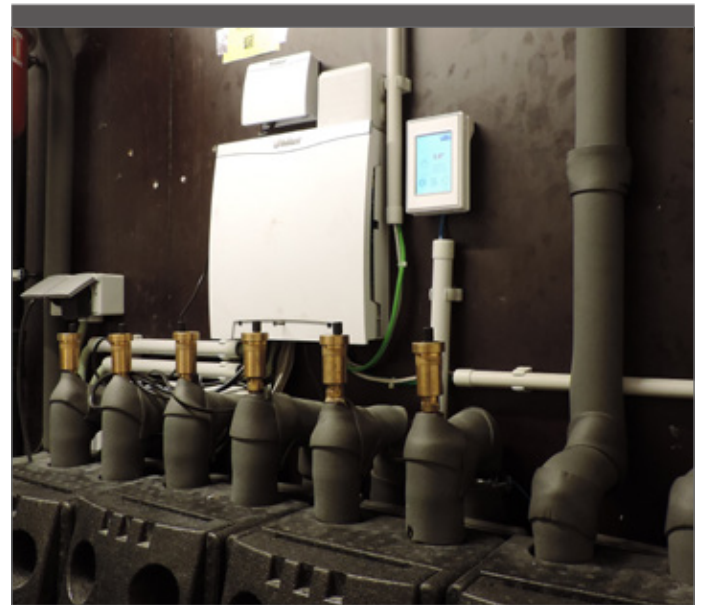
Drie circuits voor de centrale verwarming, één circuit voor het warm water.
