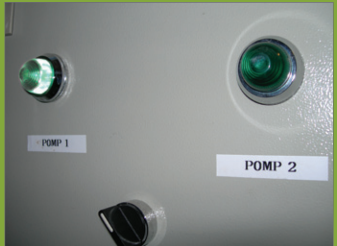
De vermaalpomp wordt aangestuurd door een schakelbord.
