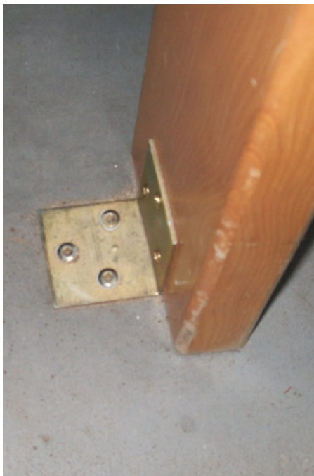
Verankerd meubilair kan niet verplaatst worden, waardoor de kans op schade verkleint.
