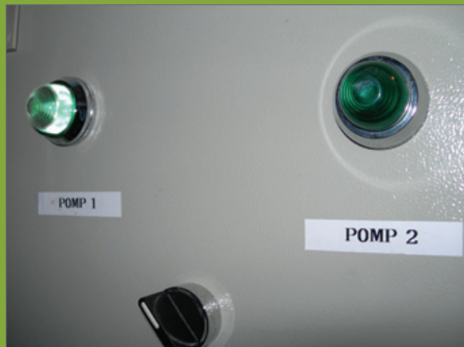
De vermaalpomp wordt aangestuurd door een schakelbord.
